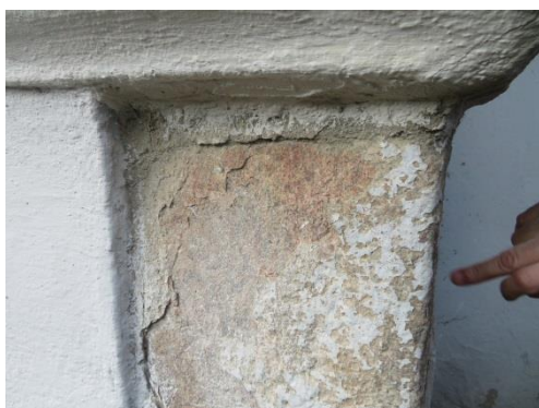
Zdjęcie nr 28. Cofnięcie lica narożnika.
