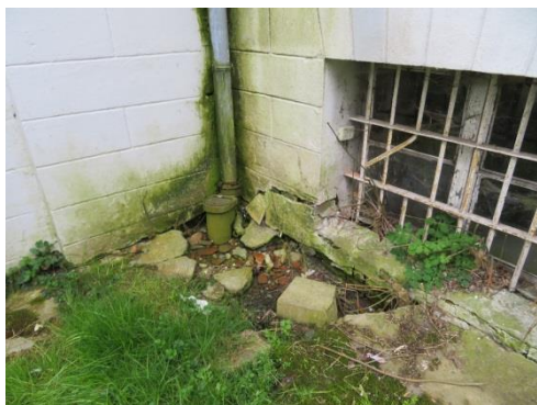
Zdjęcie nr 30. Zawilgocenie od zewnątrz.
