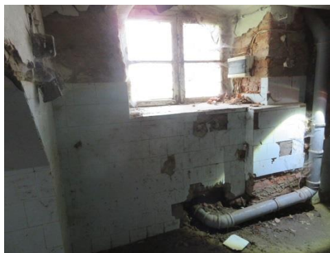
Zdjęcie nr 31. Zawilgocenie od wewnątrz.
