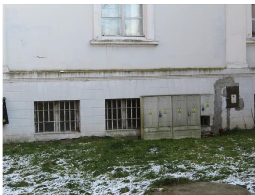
Zdjęcie nr 29. Zamaskowany cokół i okna piwnic szafkami ele.
