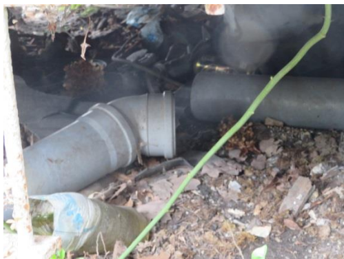
Zdjęcie nr 53. Rozłączenie rur spustowych pod tarasem wejścia frontowego.
