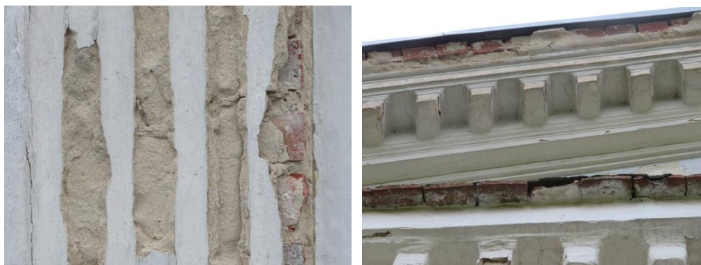
Zdjęcie nr 46, nr 47. Ubytki w kanelurach pilastrów i ubytki w gzymsie klockowym na tympanonach.
