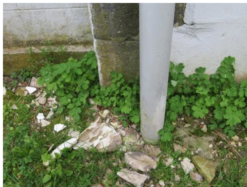
Zdjęcie nr 58. Brak klapy rewizyjnej.
