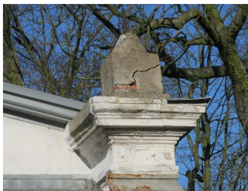
Zdjęcie nr 12. Ubytek sterczyny.
