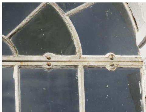
Zdjęcie nr 35. Łączenie w oknie O22.
